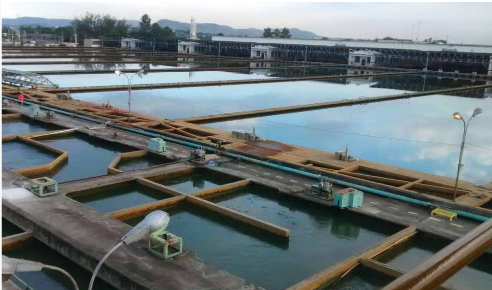
Estação de tratamento do Rio Guandu
